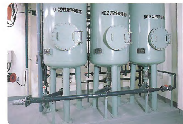
活性炭吸着塔
